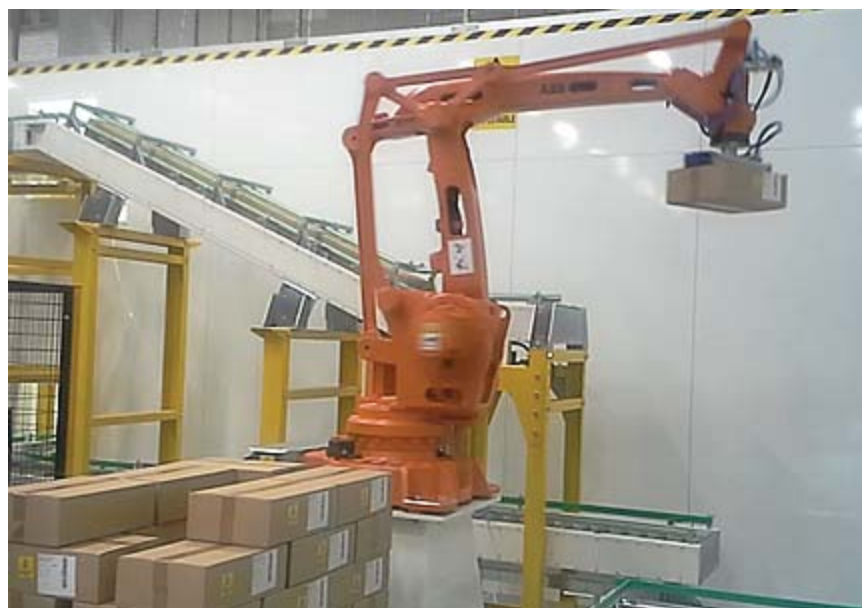
Il Robot ABB IRC5 incaricato della pallettizzazione. L'area è resa sicura da barriere di protezione.
